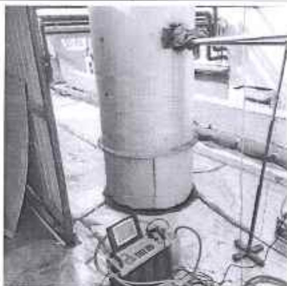
图 2-3 热经炉燃烧废气现场采样照片
